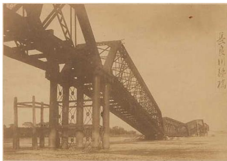
くずれた長良川鉄橋
