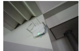
Wi-Fi設備(令和5年～閲覧室内)
